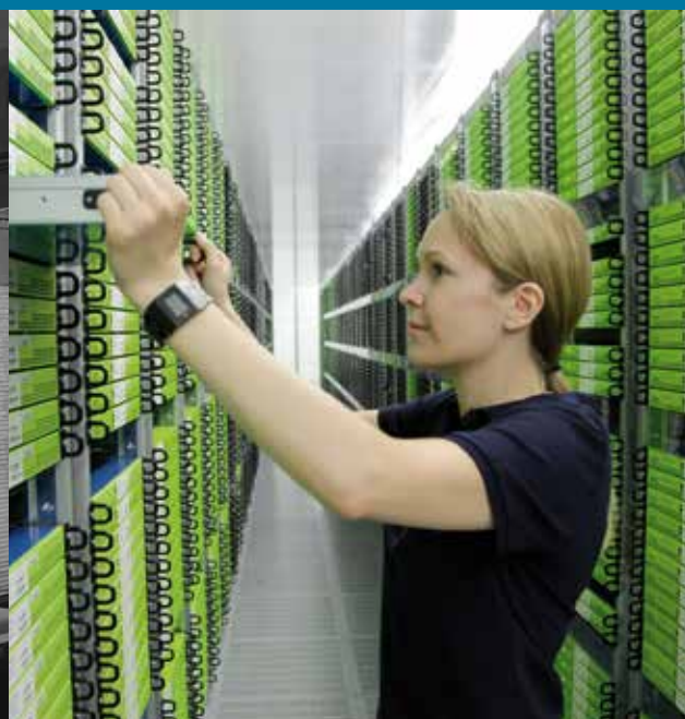
2015: Wartungsarbeiten in einem Datenzentrum, der Rackeinschub ist ein Server.
